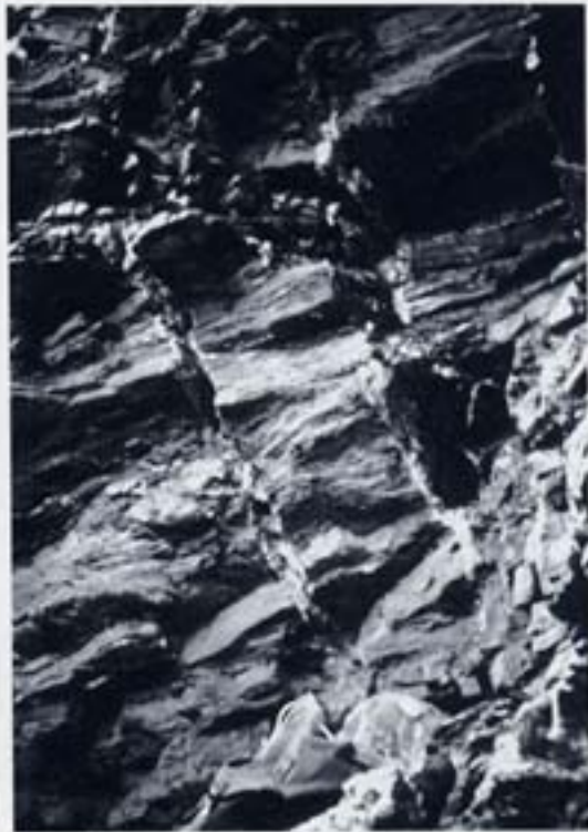
Abb. 17 — 1 Kluftspalte von wenigen Zentimetern Breite im «Kieselkalk der Via Mala».
